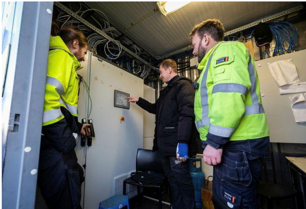
Anläggningen har körts i verkstaden men nu ska den trimmas in med rötgas från Dan Waldemarssons biogasanläggning. FOTO: HANS DAHLGREN
