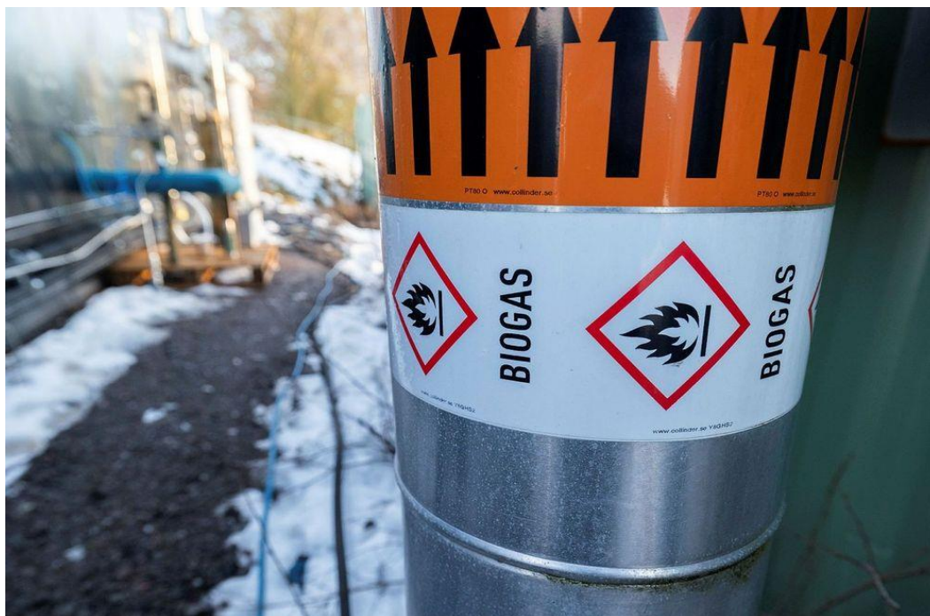
Dan Waldemarssons biogasanläggning har producerat el och värme i över tio år. FOTO: HANS DAHLGREN
